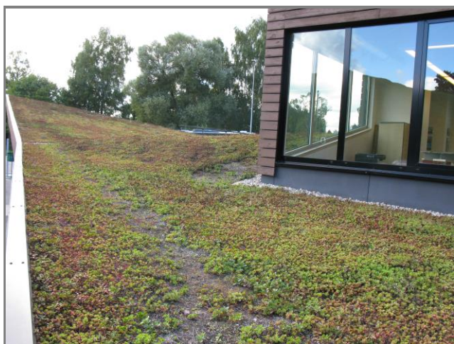
Фото 3. Выпадения очитков в местах вымывания почвы на скатах крыши центра творческих услуг 'Zeimuļš'. Fig. 3. Stonecrops fallen out in places washing out soil on the roof slopes of the Creative Services Centre 'Zeimuļš'
