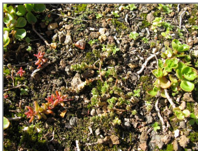
Фото 4. Ослабленные экземпляры S. acre и S. album в растительном покрове скатов крыши центра творческих услуг 'Zeimuļš' Fig. 4. Enfeebled shoots of S. acre and S. album in vegetation cover on the roof slopes of the Creative Services Centre 'Zeimuļš'
